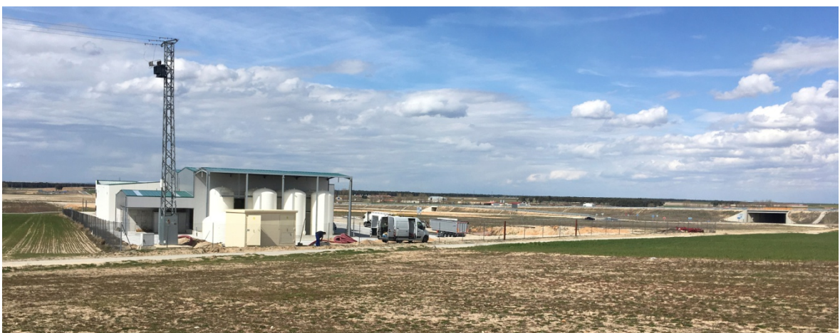
Vista desde el Suroeste. En primer término el centro de transformación
